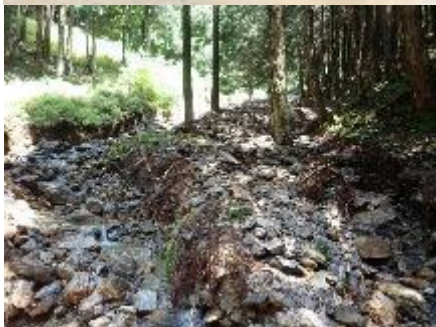
溪流荒廃状況
