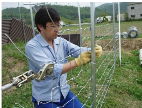
●上網の中央より下の横線をウインチで緊張をかける（上網の上部で緊張をかけると、支柱が動き、下網が弛むので、上部は緊張をしない）
