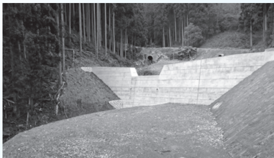
福知山市市寺（平成28年1月） (平成26年度災害関連緊急治山事業で実施)
