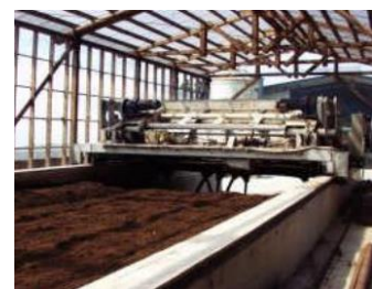
堆肥の自動攪拌機
