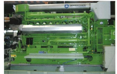
消化ガス発電装置
