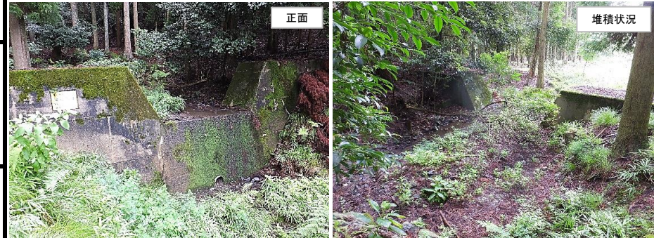
① 既設治山ダム(昭和50年度施工)の正面及び堆積状況
