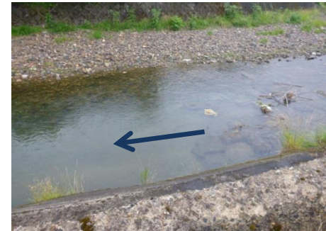
根詰めブロックが流亡
