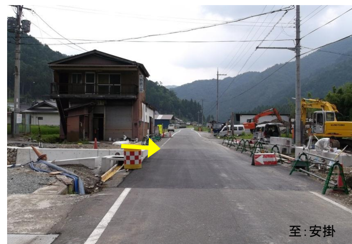
終点側交差点の状況 建物で起点からの車両が見にくい
