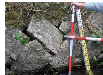
空石積みの損傷状況
