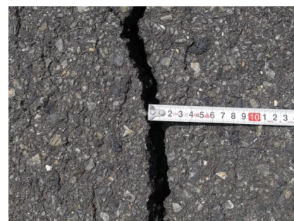
道路面のクラック 約1.5cm
