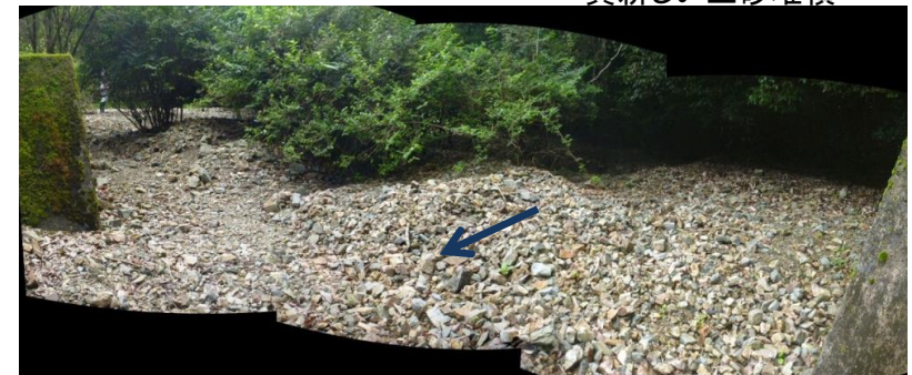
水通し上部にも土砂堆積
