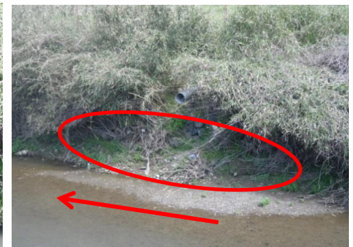
土羽の裾の小規模な崩れ
