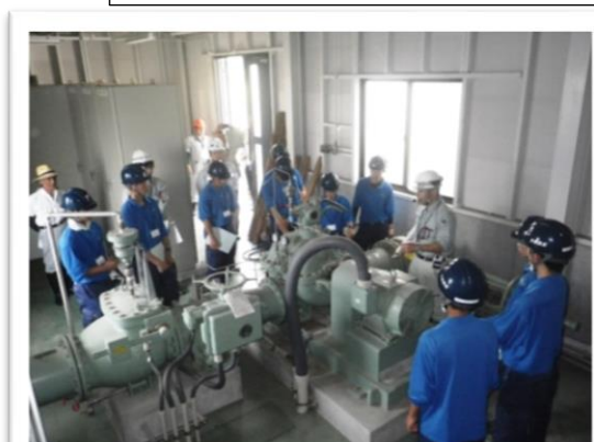
国営亀岡地区幹線用水で揚水機について学ぶ
