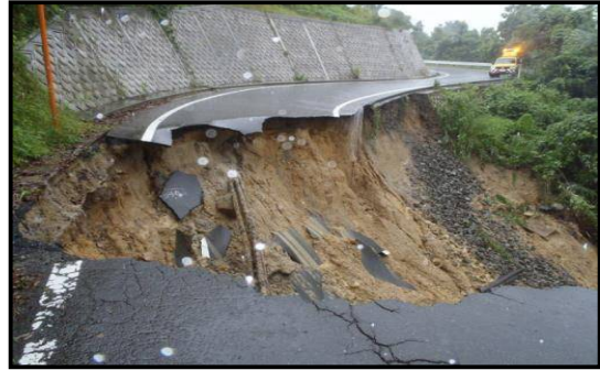
平成 30 年 7 月豪雨 平成 30 年 7 月 6 日～7 月 8 日 (舞鶴宮津線 (宮津市皆原) の路肩欠壊)
