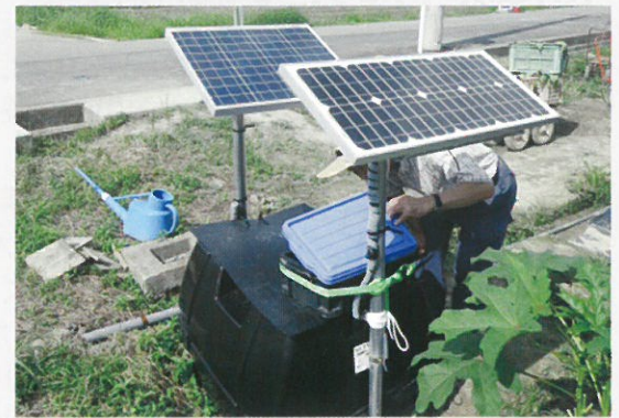
写真1 日射制御型拍動自動かん水装置 パネル2枚を用い自動化 (水路→タンク、タンク→点滴チューブ)
