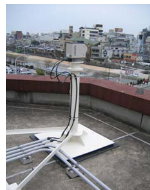
鴨川沿川の防災カメラ
