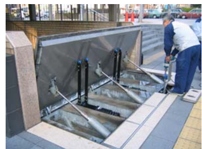
京都駅前地下街入り口の止水板
