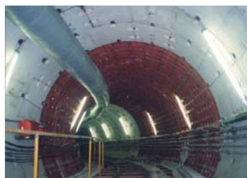
吐口から流れ出す水の量を減らすため、 下水を貯める貯留管の建設 (京都市上下水道局HPより)
