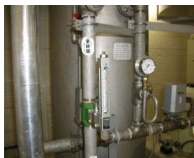
公共施設での雨水利用施設その1 (京都市庁西別館の地下)
