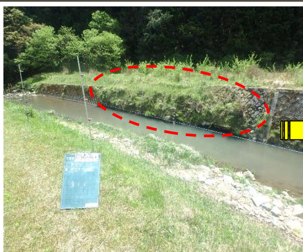
河川護岸が崩れかけており危険
