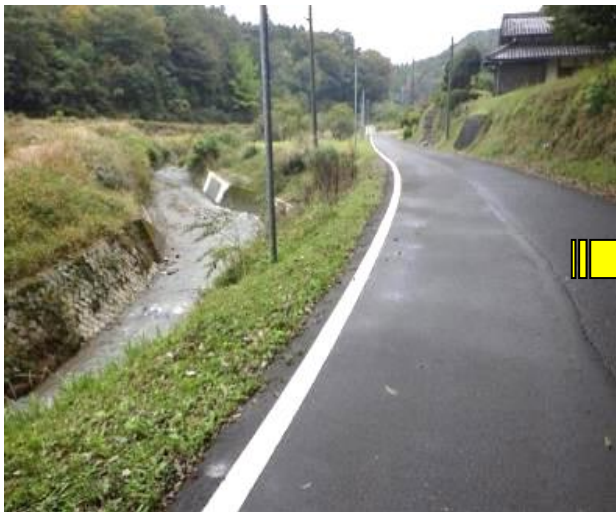
車両などが川に転落しそうで危険
