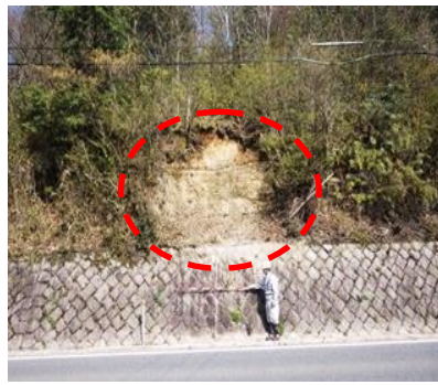
のり面が崩れている
