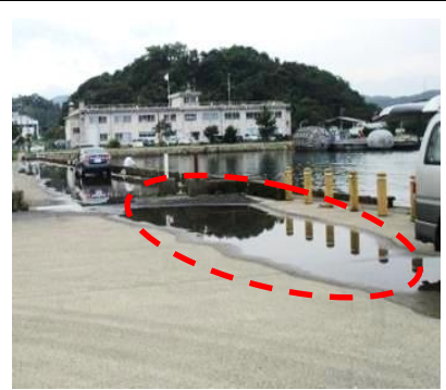
舗装が沈んでいる
