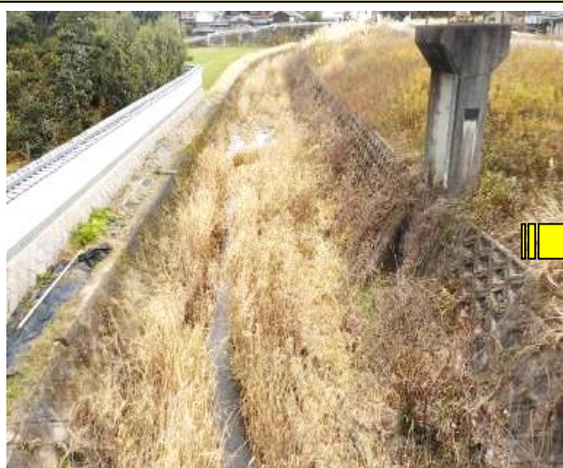
土砂が河川を阻害しており危険
