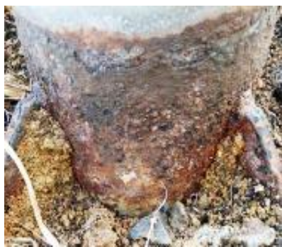
標識柱の根元が錆びている
