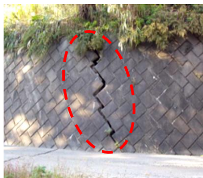
構造物が壊れている
