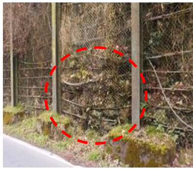
落石用の網や柵が壊れている
