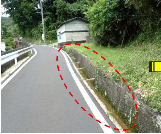
道路側溝に蓋がなく歩行空間が狭小
