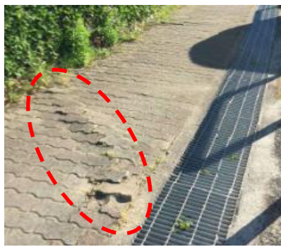
園路に段差ができている
