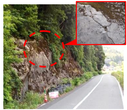
のり面がひび割れている
