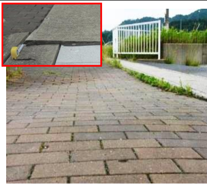
歩道が沈んでいる
