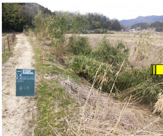
樹木が河川を阻害しており危険
