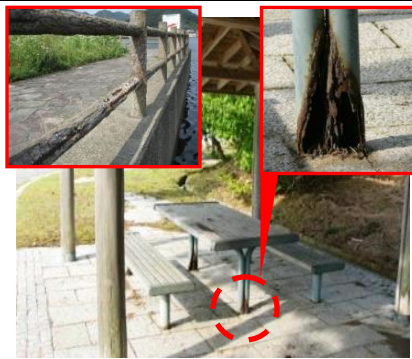
施設が壊れている
