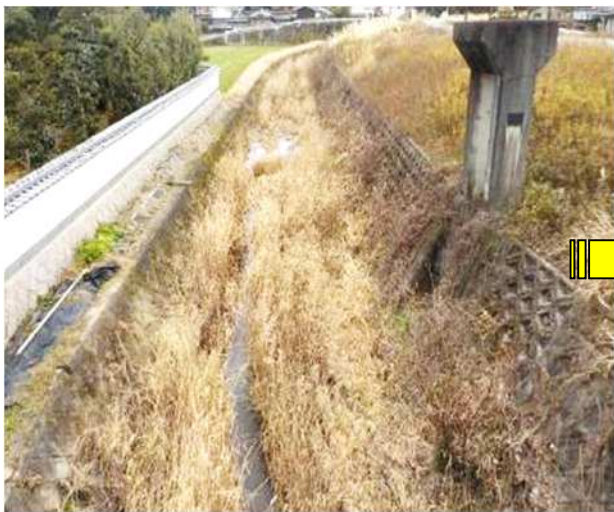
土砂が河川を阻害しており危険
