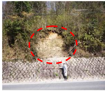
のり面が崩れている
