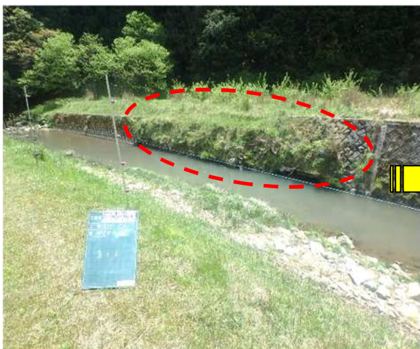
河川護岸が崩れかけており危険
