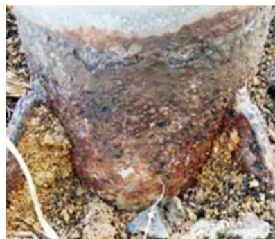
標識柱の根元が錆びている
