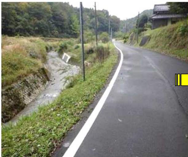
車両などが川に転落しそうで危険
