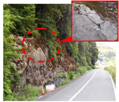
のり面がひび割れている
