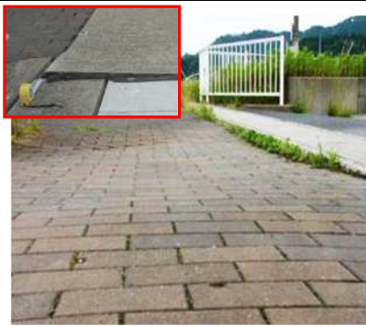
歩道が沈んでいる
