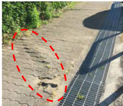
園路に段差ができています
