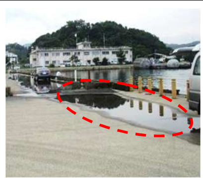
舗装が沈んでいる
