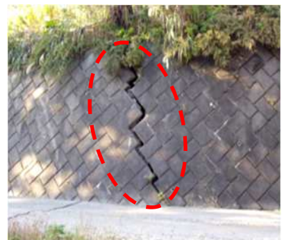
構造物が壊れている
