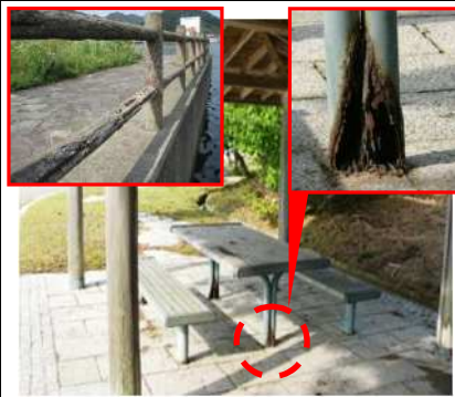
施設が壊れている
