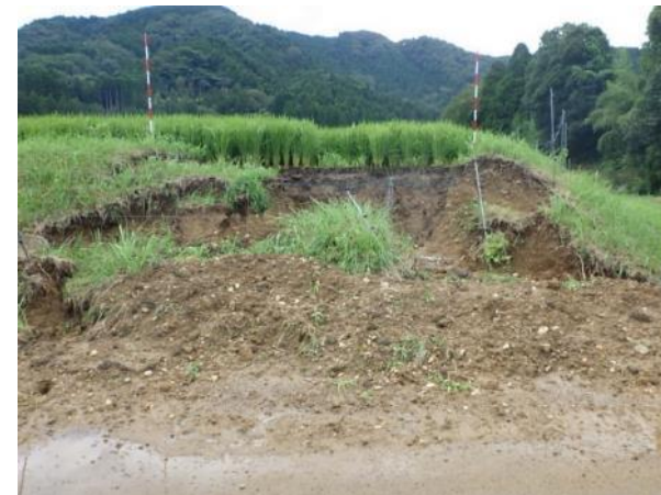
田の法面崩壊(綾部市)
