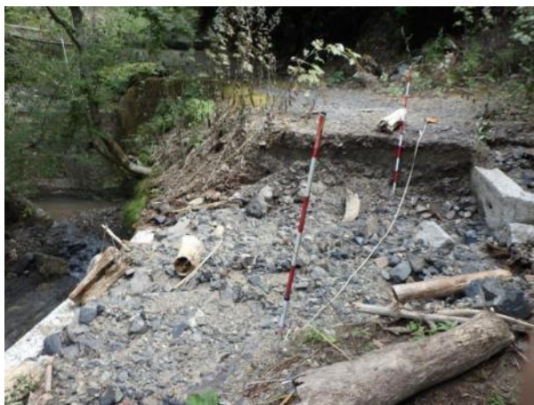
林道の被災(舞鶴市)
