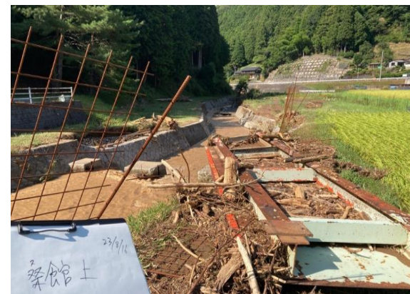
鳥獣侵入防止柵の被災(舞鶴市)
