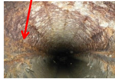
コンクリート管の腐食
