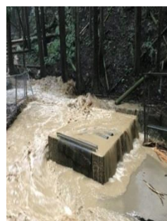
取水場の浸水
