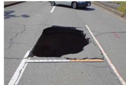
公共下水道管の劣化に 起因する路面陥没
