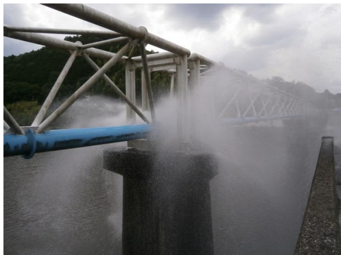
老朽水道管の破裂事故
