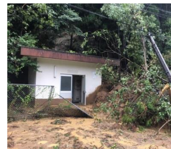
ポンプ場の浸水
