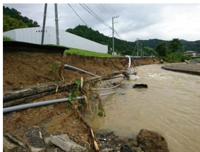
水道管・下水道管が損傷
