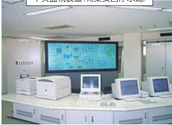
中央監視装置(物集女西浄水場)
