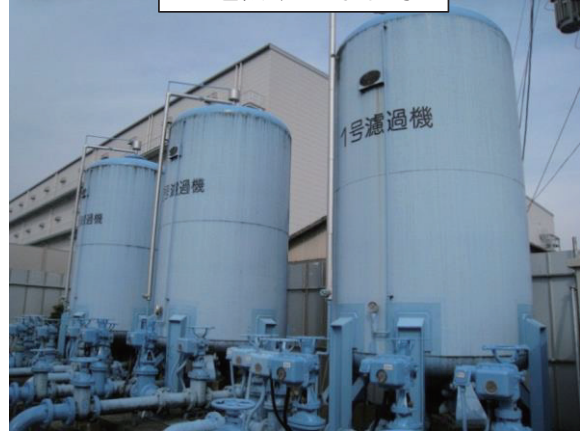
ろ過機(佐古浄水場)
