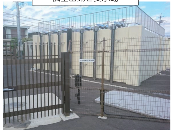
仏生田第2受水場
