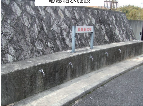
応急給水施設
