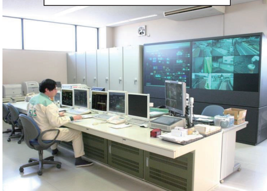
浄水場監視室(美濃山浄水場)
