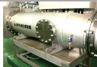
紫外線処理室(薪浄水場)
