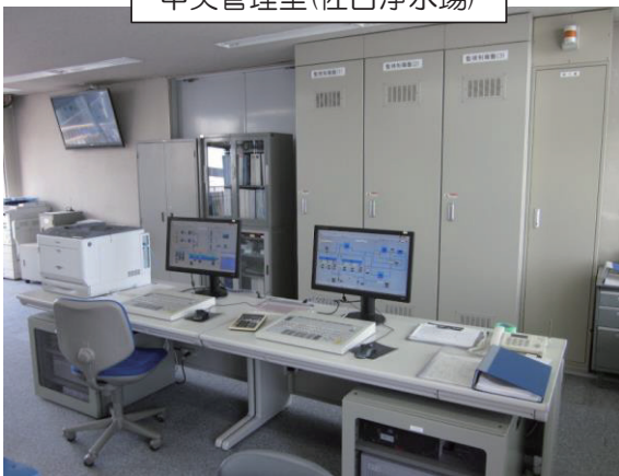
中央管理室(佐古浄水場)
