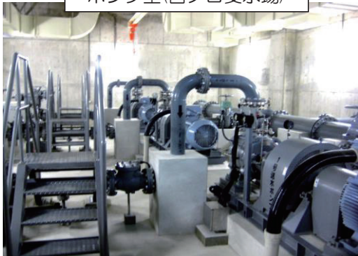
ポンプ室(宮ノ口受水場)
