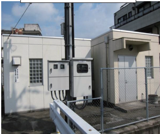
京都府営水道第1受水施設
