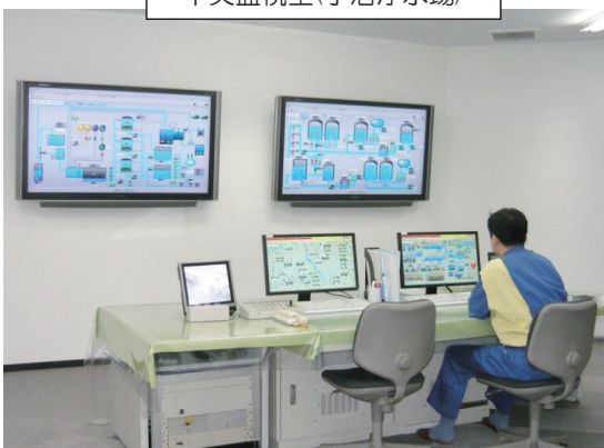
中央監視室(宇治浄水場)
