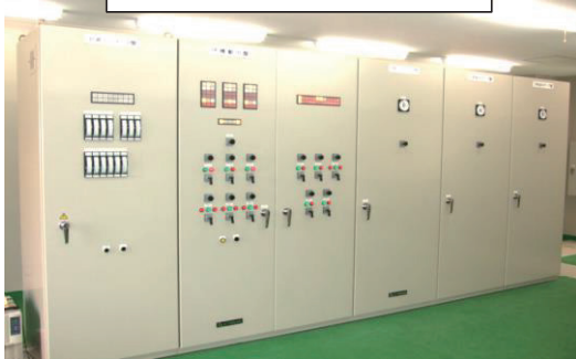
電気室(宮ノ口受水場)
