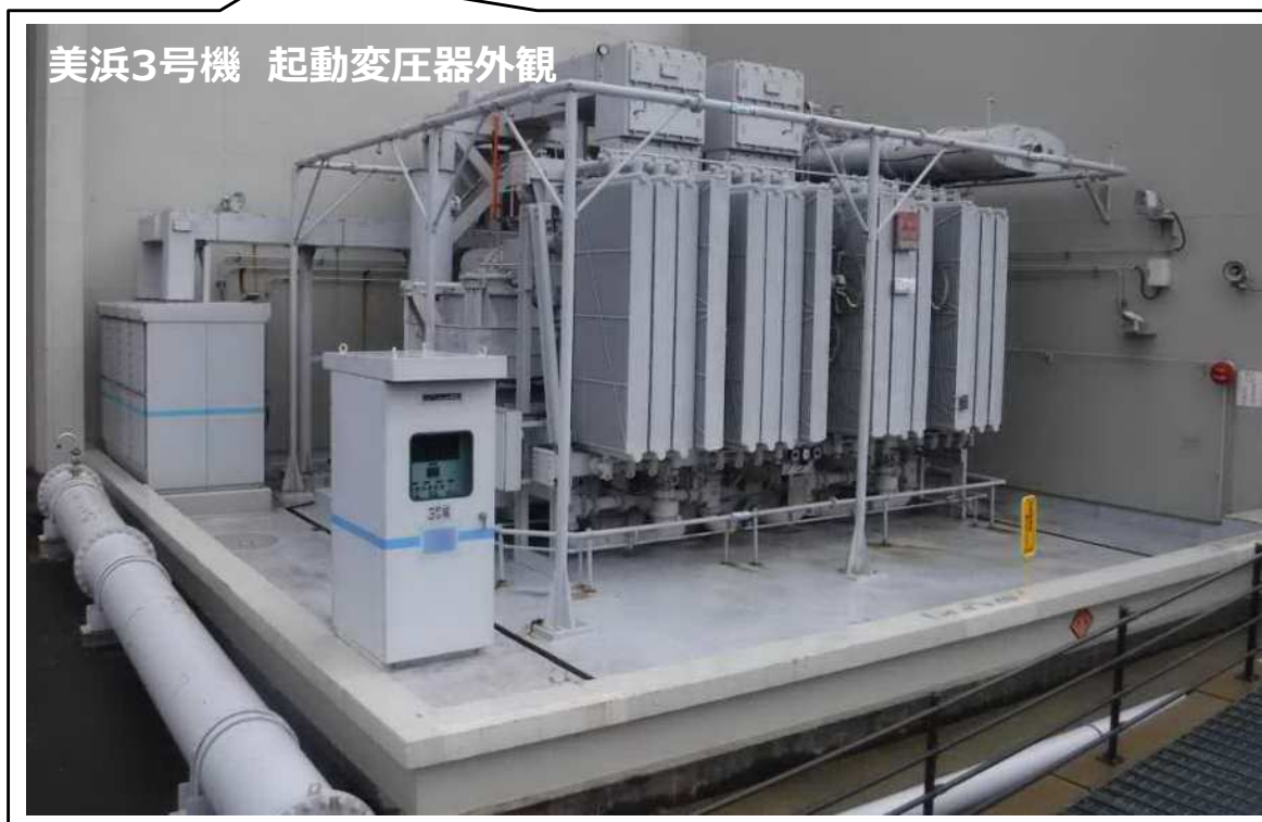
変圧器からの油漏れが発生した場合、漏れ出た油は堰内に留まる設計となっている
