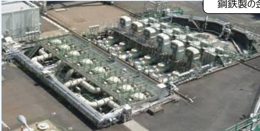
〔竜巻飛来物対策設備設置前〕
