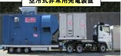
空冷式非常用発電装置
