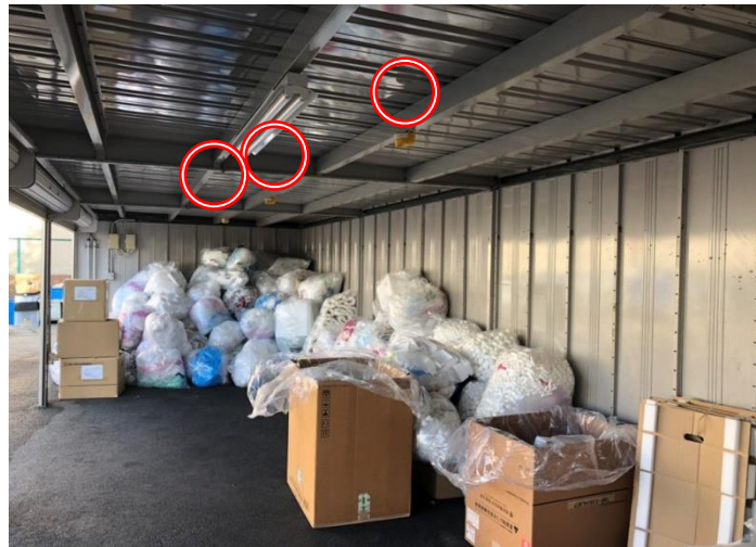
スマートセンサーを天井に設置し廃棄物の堆積状況をモニタリングする様子
