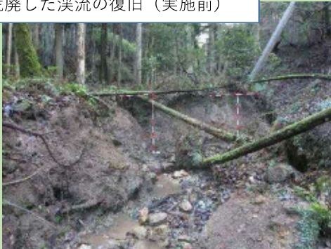
荒廃した溪流の復旧（実施前）
