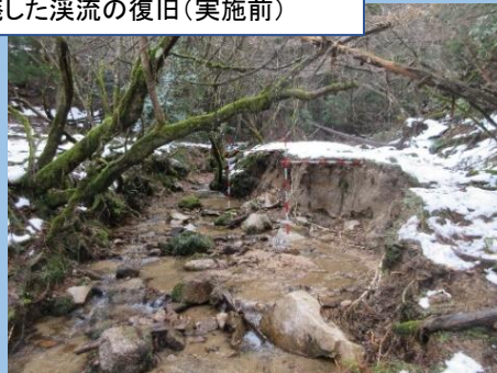
荒廃した溪流の復旧(実施前)
