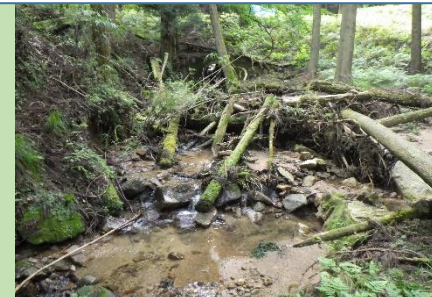
危険木の撤去(実施前)
