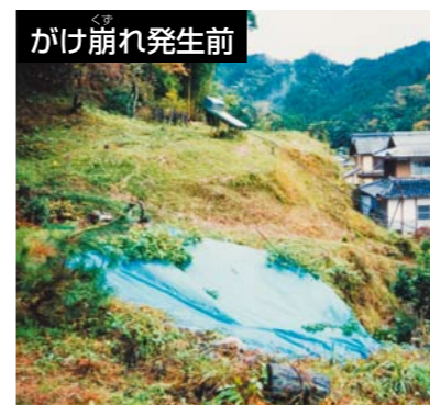
大雨によって崩れそうながけ
