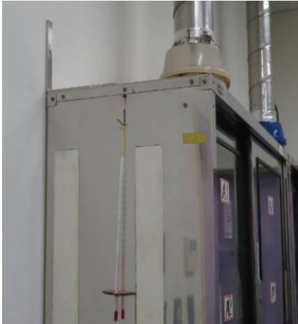
(写真 25) L字金具を用いた保管庫の転倒防止等対策の事例
