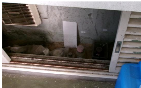
(写真2) 砂利を敷いた保管庫の扉を施錠していない事例
