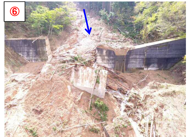
⑥ あやべしこやおかまち あさねがわ 【場 所】 綾部市古屋岡町 普通河川 朝根川 【被災状況】 砂防堰堤損傷等 延長250m 【復旧内容】 砂防堰堤復旧工 100,000千円
