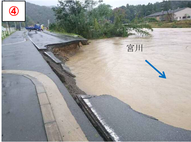
④ ふくちやましおおえちようせき おやべおおえみやづ 【場 所】 福知山市大江町関 (主) 綾部大江宮津線 【被災状況】 河岸浸食 延長40m 【復旧内容】 大型ブロック工 40,000千円
