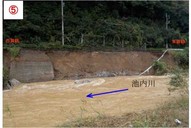
⑤ まいづるしべっしょ いけうちきょうだ 【場 所】 舞鶴市別所 (主) 池辺京田線 【被災状況】 路肩決壊、河岸浸食 延長50m 【復旧内容】 大型ブロック積工 80,000千円
