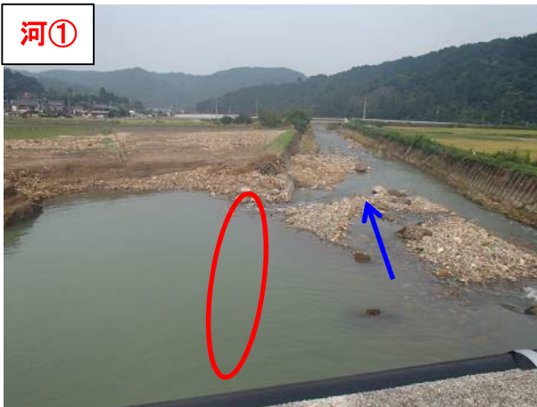
河① 【場 所】 いねちょう 伊根町 つつかわ 二級河川 筒川 【被災状況】河岸浸食 延長 1,410m (14 箇所 22 工区) 【復旧内容】ブロック積工 566,500 千円
