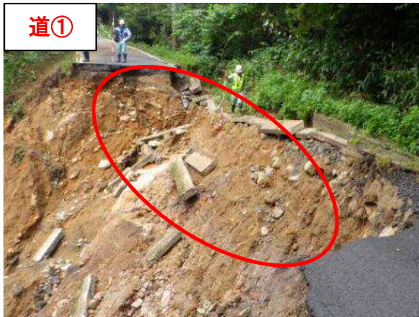
道① 【場 所】 きょうたんごし いねちょう 京丹後市・伊根町 (一) きゆうそいねせん 久僧伊根線 【被災状況】車道欠壊 延長 234m (7 箇所 7 工区) 【復旧内容】擁壁工・盛土 204,000 千円
