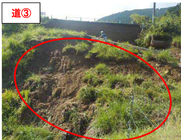
道③ 【場 所】 ふくちやまし しものじょうかみかわぐちいしやじょうせん 福知山市 (一) 下野条上川口停車場線 【被災状況】法面崩壊 延長 73m (3 箇所) 【復旧内容】吹付法柁 45,000 千円
