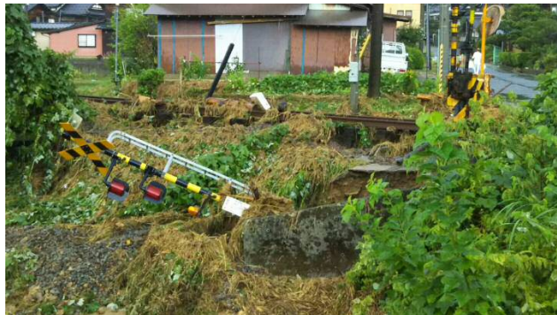
⑤ 網野～夕日ヶ浦木津温泉 【被災状況】バラスト流出、岡田第二踏切警報器倒壊
