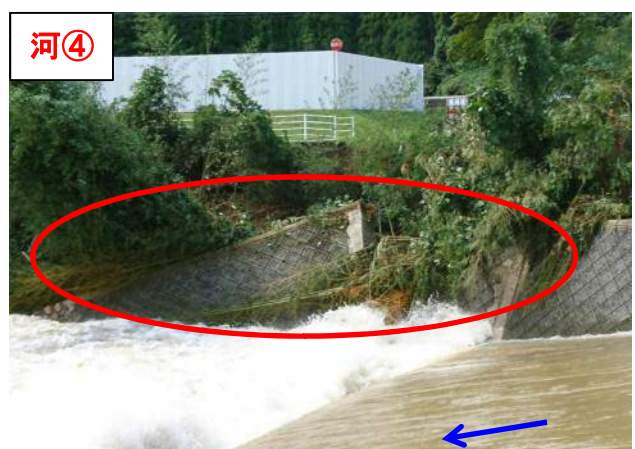
河④ 【場 所】 ふくちやまし 福知山市 みやがわ 一級河川 宮川 【被災状況】河岸浸食 延長 150m (1 箇所 1 工区) 【復旧内容】ブロック積工 45,000 千円
