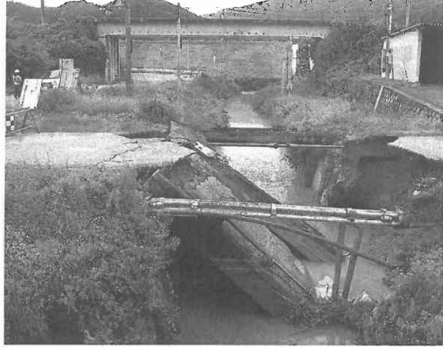
川の増水により崩落した樋ノ口橋(18日午前9時50分、福知山市大江町公庄)
