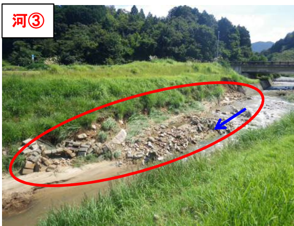
河③ 【場 所】 きょうたんごし 京丹後市 さのたにがわ 二級河川 佐濃谷川 【被災状況】河岸浸食 延長 691m (15 箇所 21 工区) 【復旧内容】ブロック積工 239,000 千円
