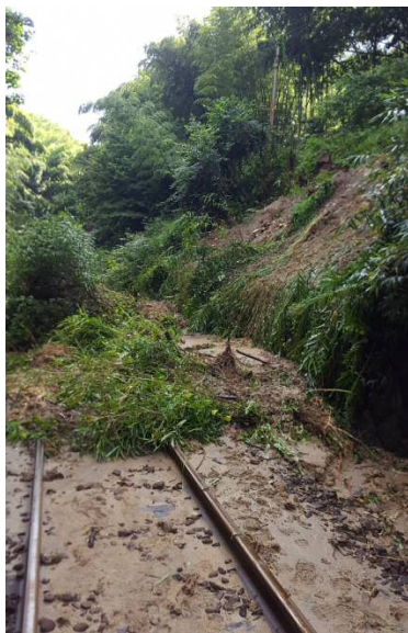
① 栗田～宮津 【被災状況】崩土 延長 120m
