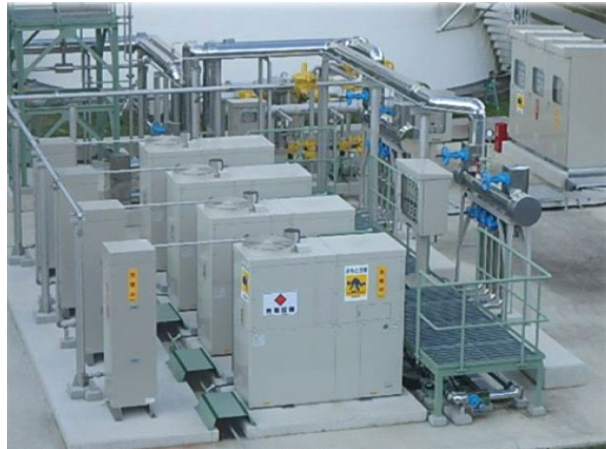
図1-17 木津川上流浄化センター消化ガス発電設備
