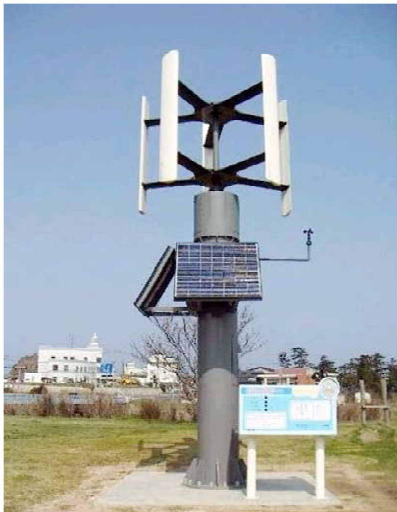
図3 - 7 道の駅「てんきてんき丹後」に設置された風力発電
