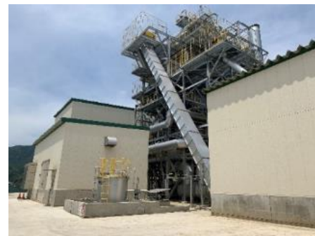
写真 3-1-9 令和2（2020）年から稼働している舞鶴市内の木質バイオマス発電所 （写真提供：林ベニヤ産業株式会社）
