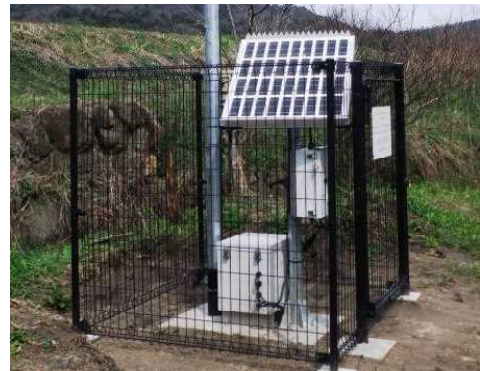
図1-20 設置例（宮津市内）
