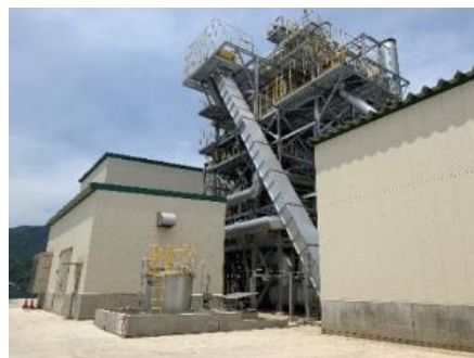
写真 3-1-7 令和2年から稼働している舞鶴市内の木質バイオマス発電所 （写真提供：林ベニヤ産業株式会社）
