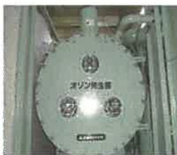
オゾン発生装置
