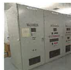
遠方監視制御装置
