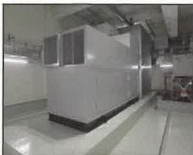
自家発電機設備 (イメージ)
