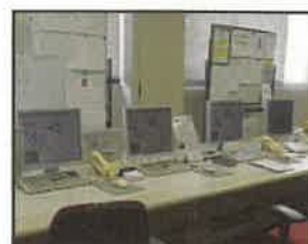
中央監視制御装置
