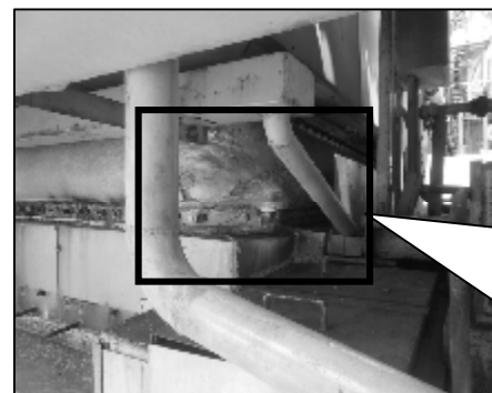
空気予熱器の伸縮継手部
