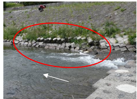
損傷している護岸（鴨川）
