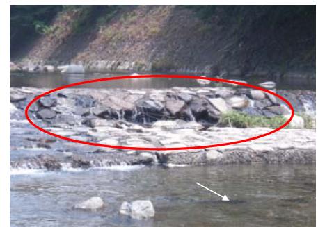
損傷している落差工（高野川）
