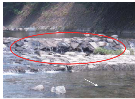
損傷している落差工（高野川）
