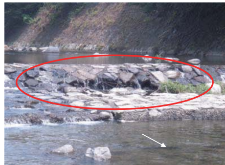
損傷している落差工(高野川)
