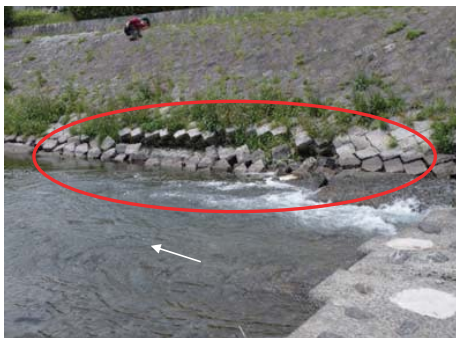
損傷している護岸(鴨川)
