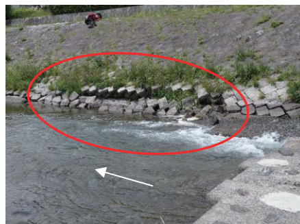
損傷している護岸（鴨川）
