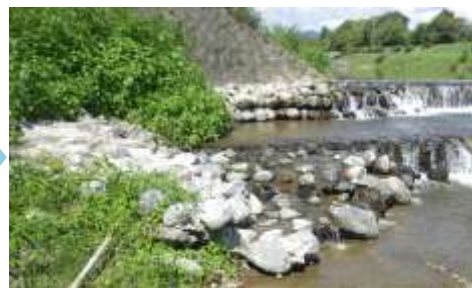
練積みで再設置(H30.3施工) 7月豪雨で大きな損傷なし
