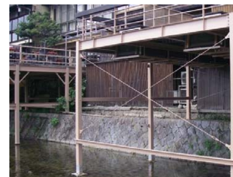
独自に室外機対策が施工されている事例
