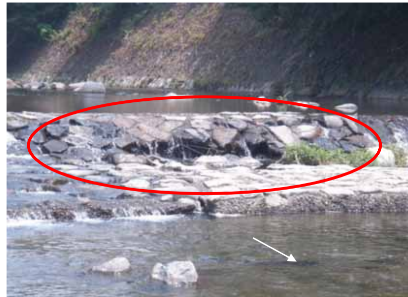
損傷している落差工(高野川)
