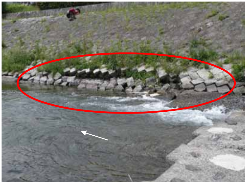
損傷している護岸(鴨川)
