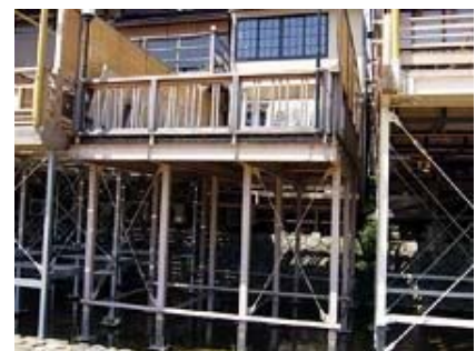
隣り合う床の高低差が大きく、不揃いな状況となっています
