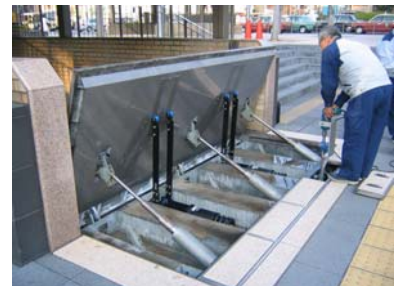
京都駅前地下街入り口の止水板
