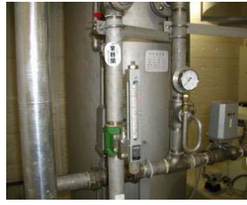
公共施設での雨水利用施設その1 (京都府庁西別館の地下)
