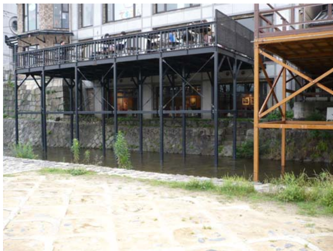
護岸が低く浸水の恐れがある箇所
