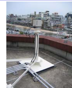
鴨川沿川の防災カメラ
