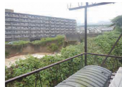
平成24年8月豪雨 弥陀次郎川の欠壊状況
