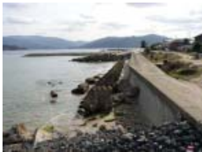
老朽化した既設護岸
