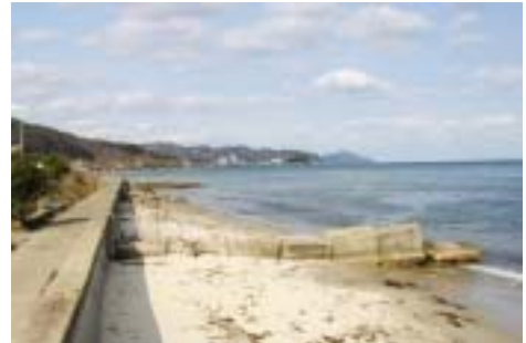
老朽化した海岸保全施設
