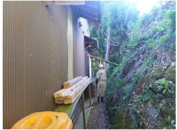
【写真番号⑭】 8No.3 付近の状況
