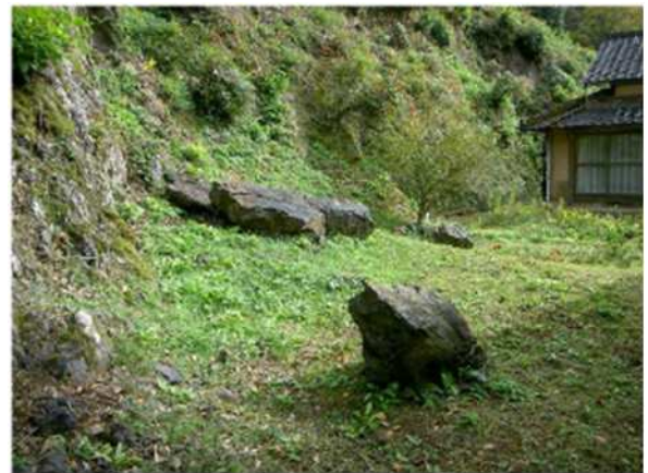
【写真番号⑯】 落石状況 (2No.0+5.0 付近)
